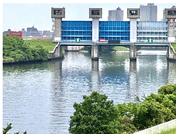
現在稼働中の岩淵水門
